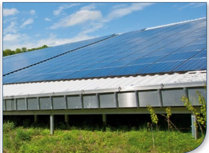
PV-Module auf der regendichten Wellblech – Konstruktion (hell). Unten am Rand: Überdimensionale Regenrinne.
