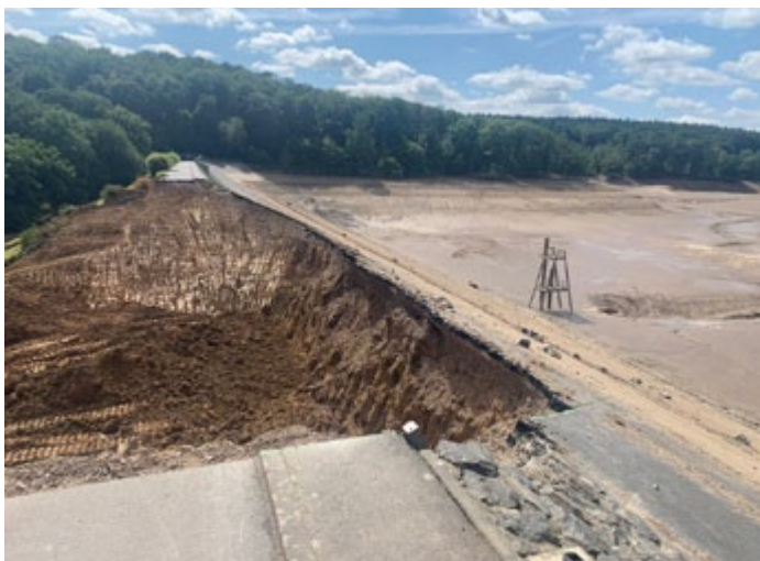
Schäden am Straßen- ...
